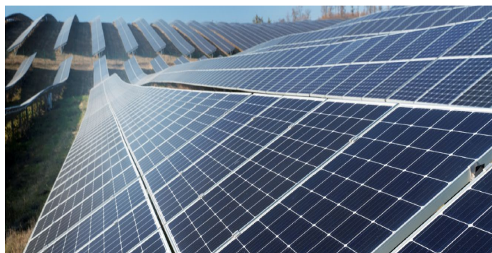
SMART centrais fotovoltaicas – Instalação, manutenção e gestão
