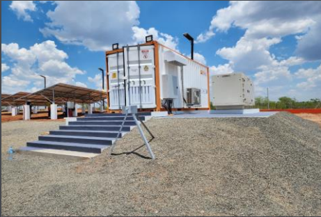
Central fotovoltaica de Chintolo
